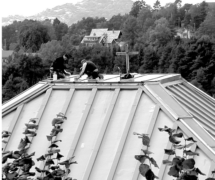
Taktekkere tettet i september glasstaket på Søreide kirke, men det er fortsatt lekkasjer andre steder på taket.
