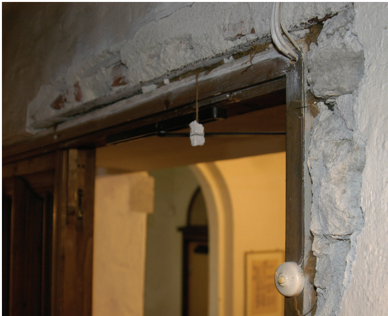
NEDSLITT: Murpussen på veggen er begynt å falle ned inne i kirkerommet.
